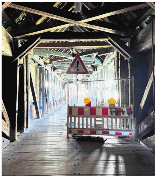
Zurzeit ist auf deutscher Brückenseite ein Teil der Fahrbahn abgesperrt.
